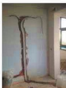
Instalação AVAC Almada
